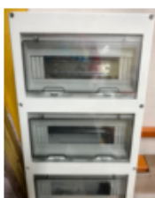
Caja de distribución
